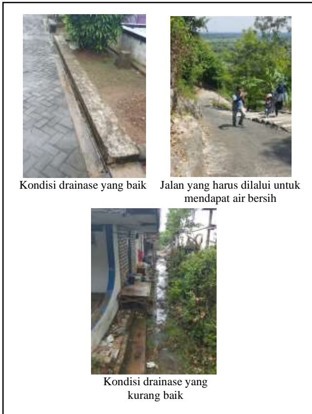
Gambar 5. Kondisi saluran drainase dan jalan di obyek wisata Bukit Surowiti
